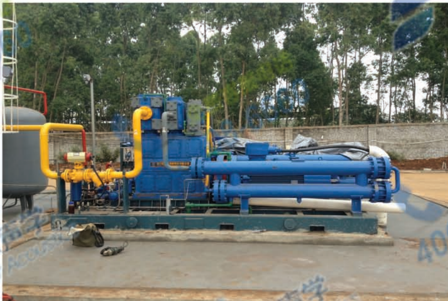
图一：施工前空压机现场图片
