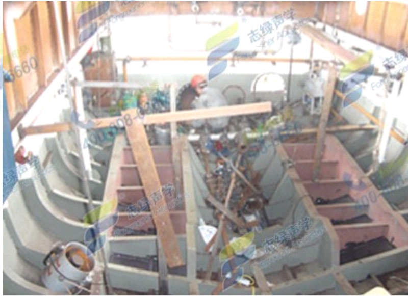
图2：志绿声学工作人员在船首底舱钢壁上涂覆阻尼隔声涂料
