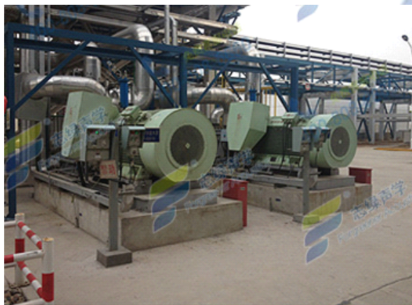
图左：隔声罩搭建前两台大型给水泵组的实际照片
