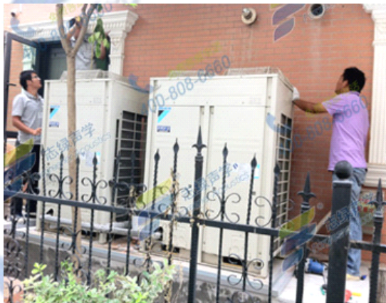
图一：别墅业主安装的两台合计28匹的大金中央空调系统。空调工作时产生的噪音高达80分贝。图中志绿的技术人员在现场进行工程测量。
